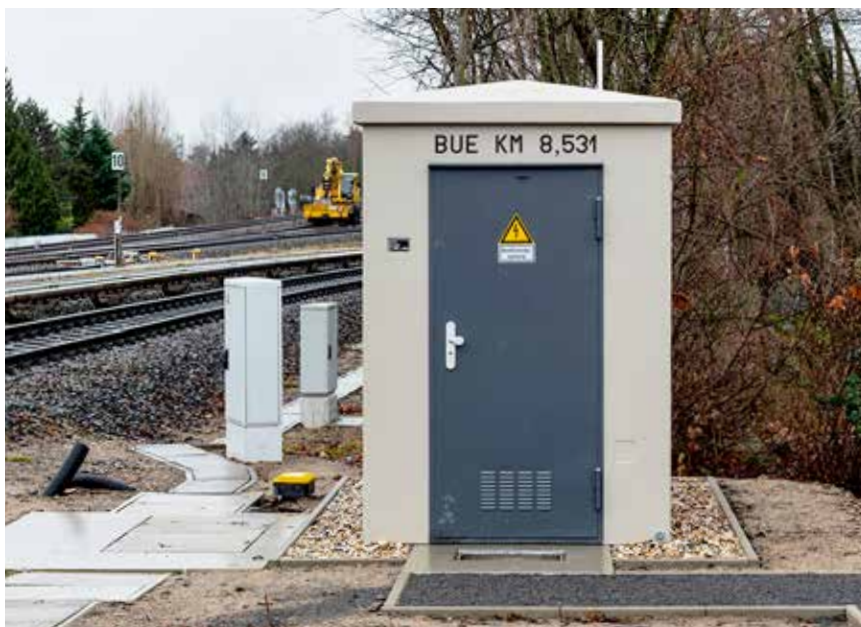
Eines der neuen Schalthäuser, hier am Bahnübergang Biesdorf
