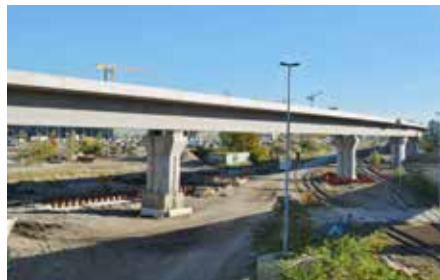
Schon im Rohbau fertig: die Brücke der neuen S-Bahn-Strecke zwischen Hauptbahnhof und Wedding.
